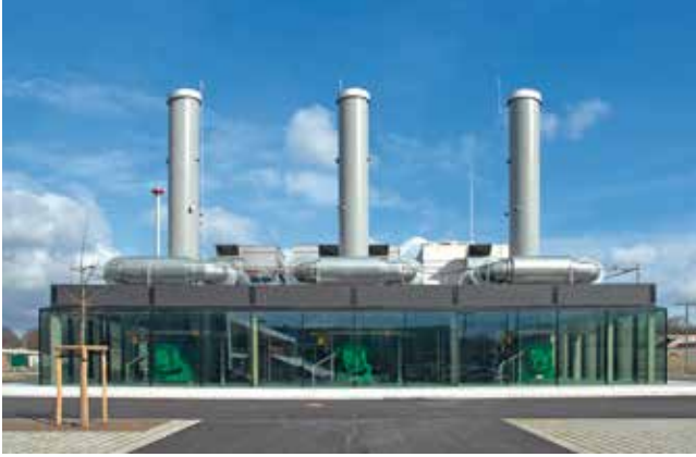
Grubengasmotorenanlage am ehemaligen Bergwerksstandort General Blumenthal 3/4 in Recklinghausen
